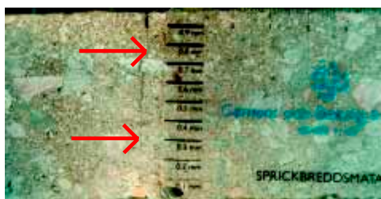
Spricka i marksten fylld med bruk (vid pilarna).
