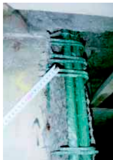
Bild 2. Delar av det täckande betongskiktet har lossnat på grund av långt framskriden armeringskorrosion.
