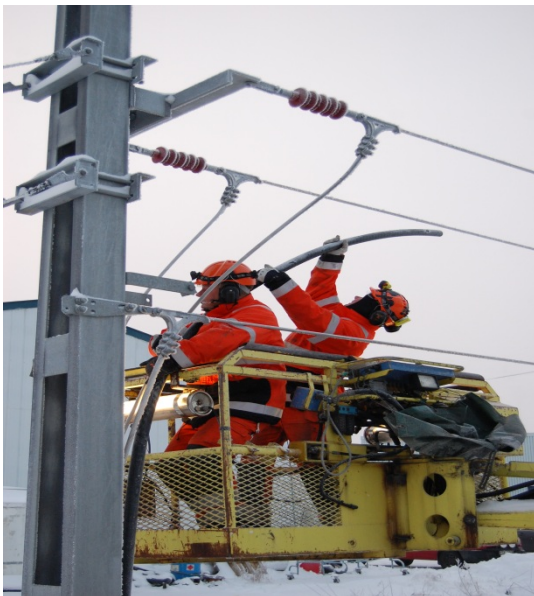
Kabelanslutning. Foto: Infranord
