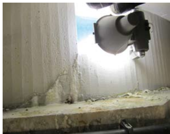
Kraftiga kloridutfällningar ur krypspricka vid ursparing för bassängväggsbelysning
